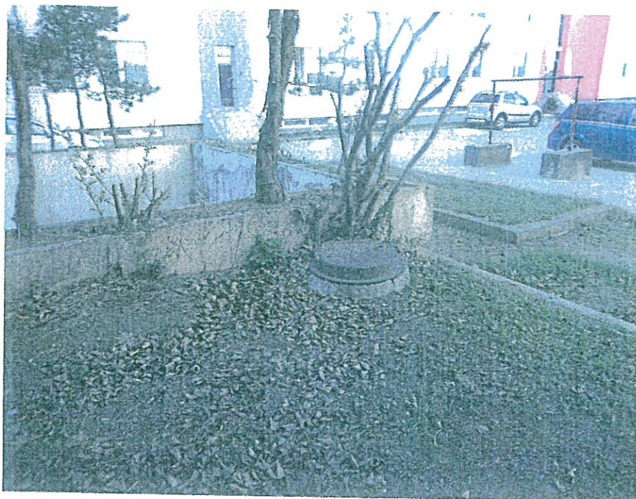
Nadmerne vyrastené dreviny v betónovom zábradlí
