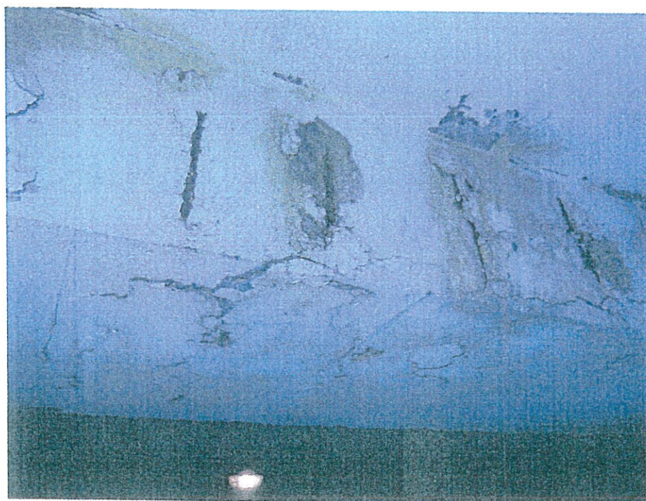
Prievlak os 7 detail odkrytej výstuže strmeňov
