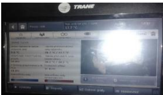
Obr.29 – Ovládací panel chillera TRANE – je zrejma energeticky neehospodárna prevádzka
