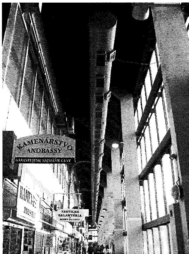
Obr. 4 – Distribučný systém – oceľové potrubie
