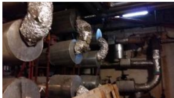
Obr.34 – Poškodené izolácie na pôvodných rozvodoch
