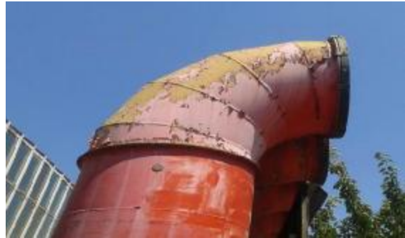
Obr.32 – Zdegradované nasávacie potrubia v exteriéri
