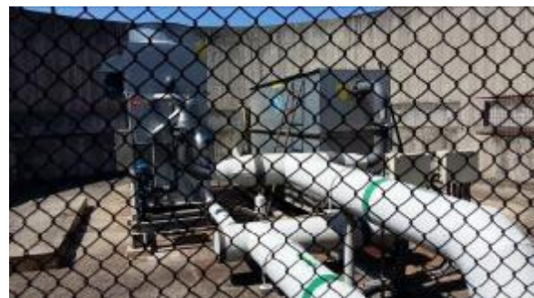
Obr.28 – Nové chladiace veže v exteriéri
