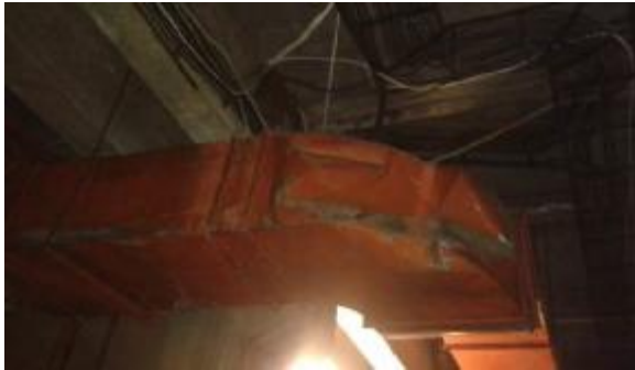
Obr.31 – Znehodnotené / poškodené časti VZT potrubí
