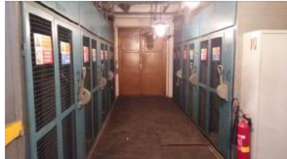
Obr. 26 – Pôvodná VN rozvodňa po hranici životnosti
