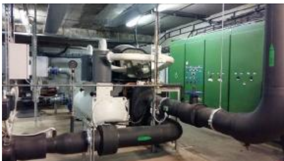
Obr.27 – Nová strojovňa chladu – neefektívne riešenie
